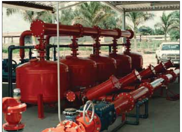
Figura 13. Equipo de filtración.
